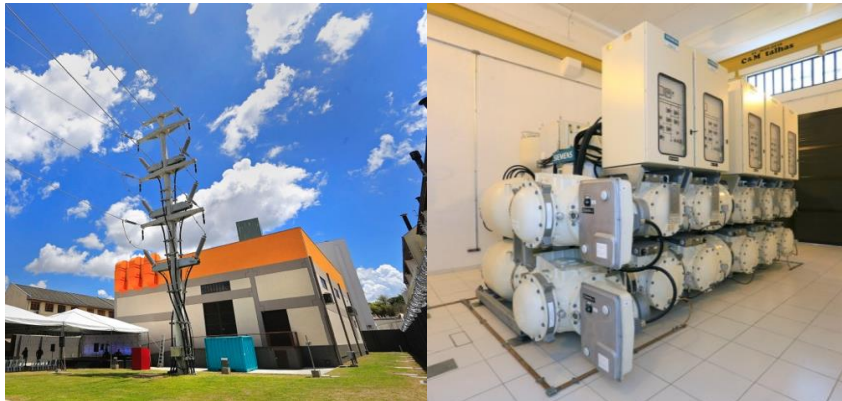
FIGURA 1 – Subestação GIS Bom Retiro Fonte: Copel 2016
