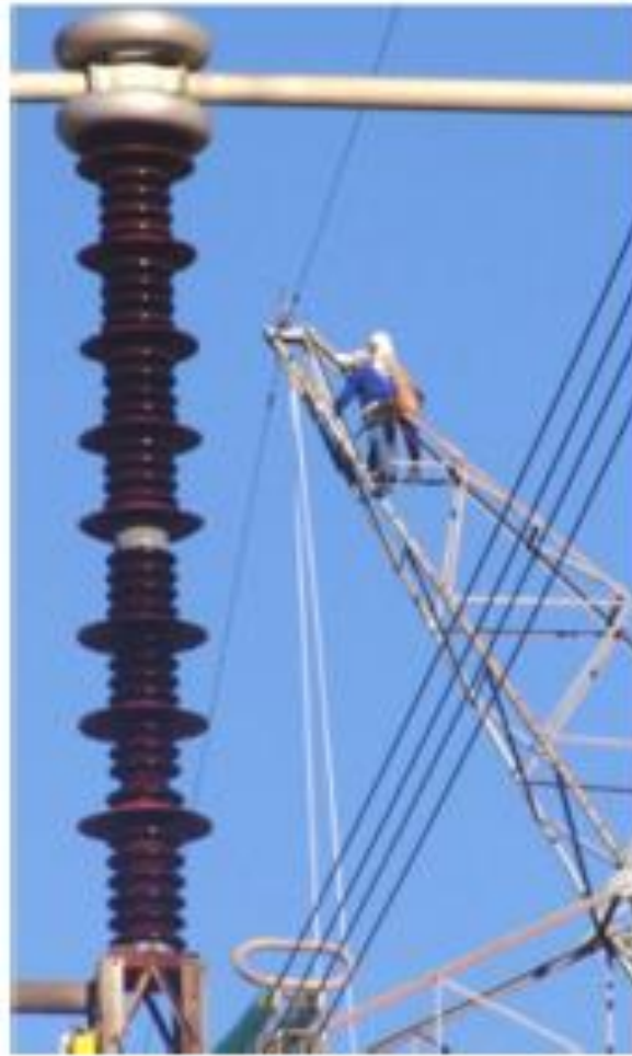
FIGURA 2 – Isolador 800 kV utilizando “booster shed” – Fonte: (3)
