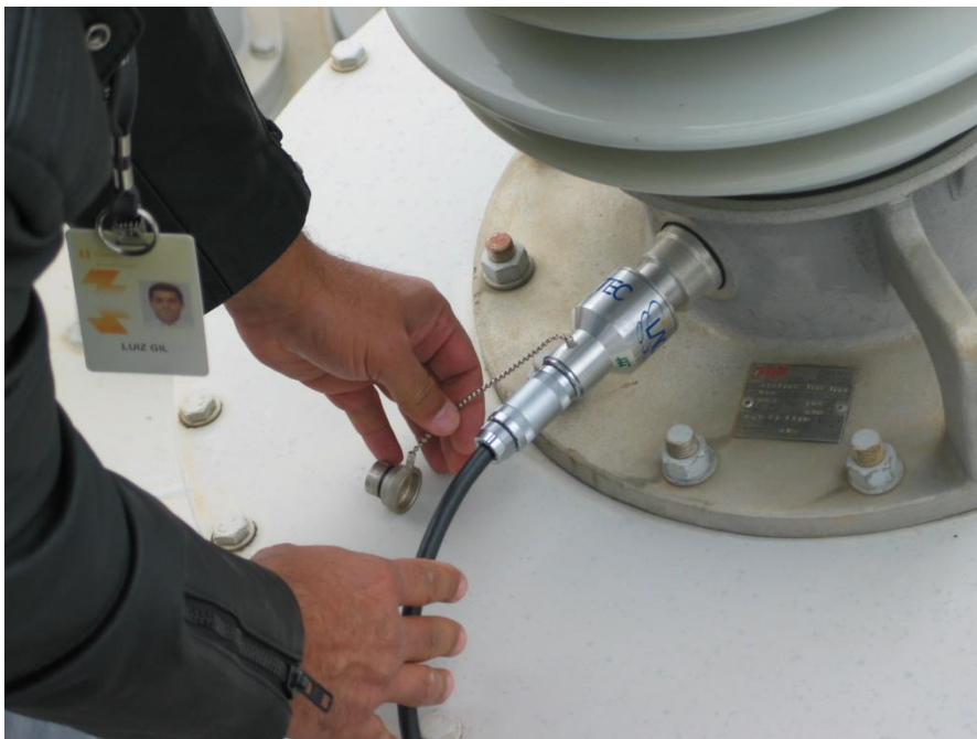
Figura 5 - Instalação do sensor de corrente [13]
