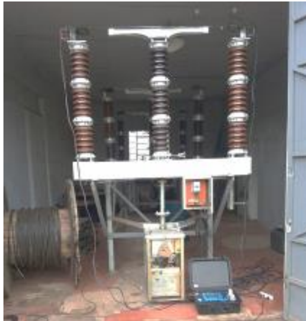
Figura 1 – Protótipo do seccionador ensaiado
