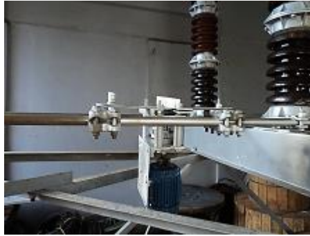
Figura 6– Motovibrador eletromecânico (Protótipo CEEE GT).
