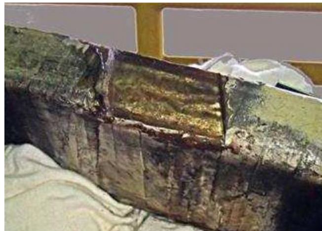
Figura 5 – Barra estatórica com isolamento desgastada
