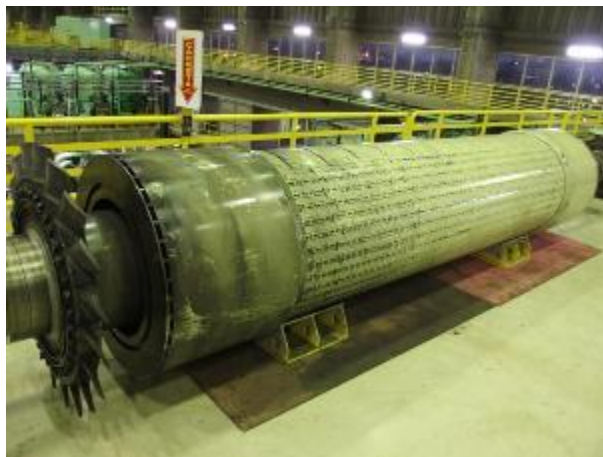
Figura 3 – Vista Geral do rotor após sinistro
