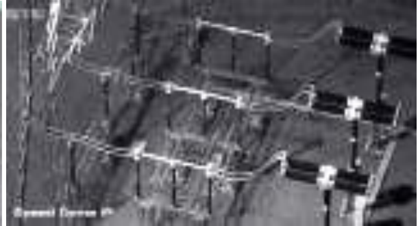
FIGURA 5 – Detalhe do seccionador aproximado
