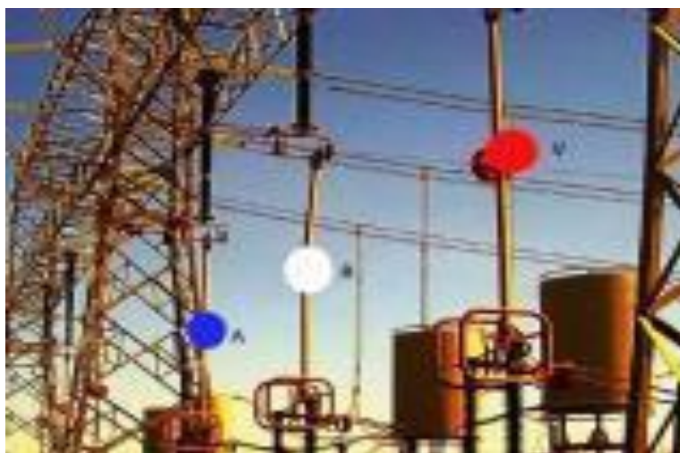
FIGURA 12 – Condição de manobra de seccionador
