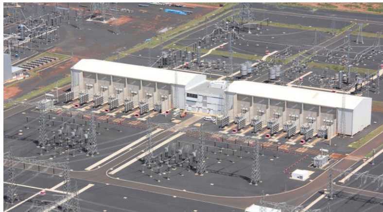
Figura 2 - SE Araraquara II (Conversoras CA/CC)
