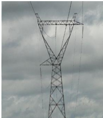
FIGURA 11 – Área suspeita na LT CXNBLT6-01 onde já foram detectados defeitos recorrentes (2013 a 2016)
