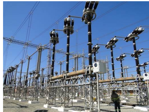
Figura 3: SE Neves 1, disjuntores de 500kV
