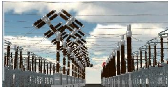
Figura 8 SRVCemig – Vista de pátio de 500kV
