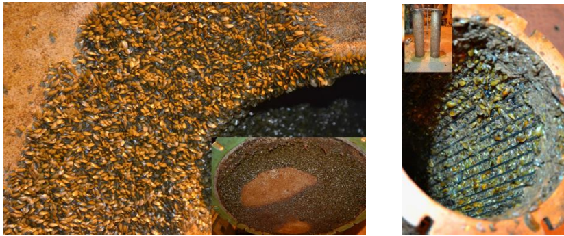
Figura 2. Infestação de L. fortunei no tanque e nos filtros de água bruta da unidade UG01 na usina de Sérgio Mota, rio Paraná.
