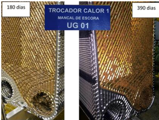
Figura 4. Placa do trocador de calor do mancal de escora e tubulação de água que alimenta trocador de calor da UG01 da usina de Sergio Mota, rio Paraná, mostrando a deposição de material e fixação de L. fortunei após 180 dias (Abril a Outubro) e 390 dias (Abril a Junho do ano seguinte) de exposição à água tratada com radiação UV.
