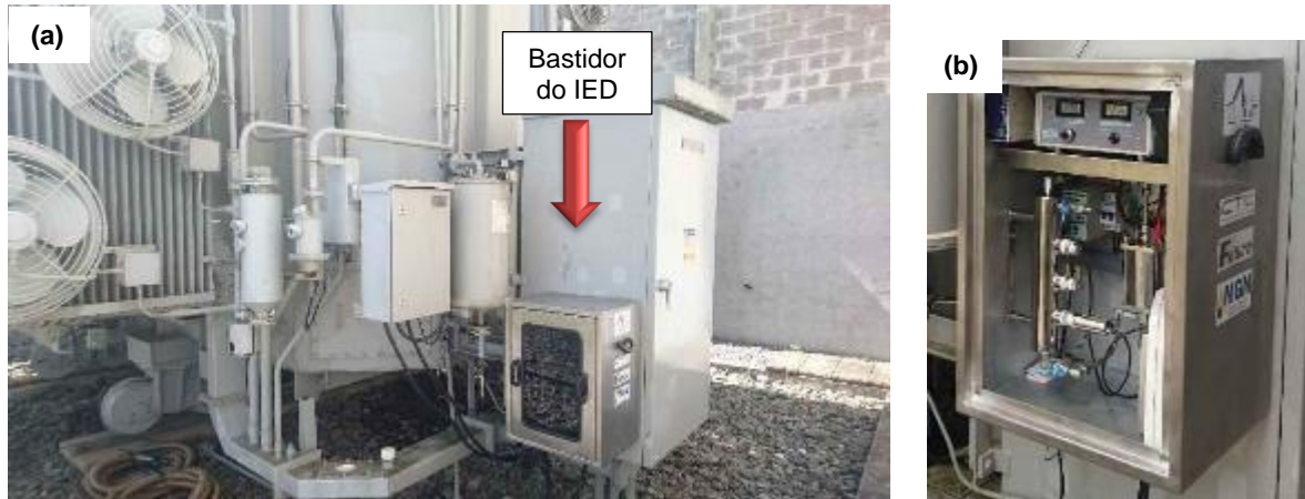
FIGURA 5 - (a) bastidor do IED instalado no transformador de 230 kV, na SE Pilarzinho da COPEL GeT, em Curitiba - (b) close-up do bastidor aberto ilustrando as conexões em fluxo e sensores.
