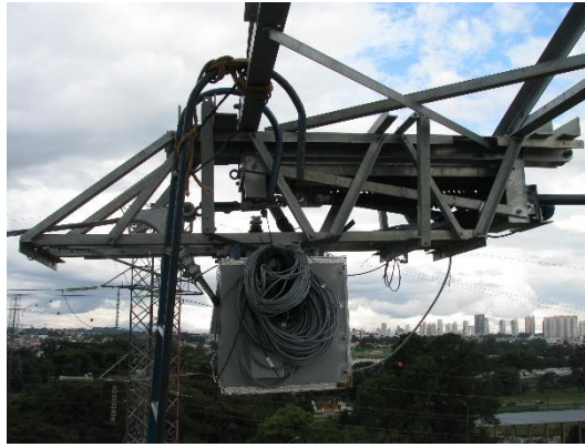
FIGURA 5 – Detalhe da instalação do sistema de vibração instalado na mísula da torre de ancoragem.
