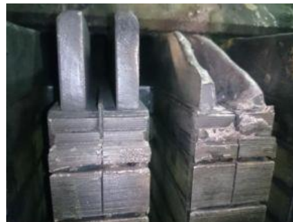
Figura 7 Dedo de pressão derretido na ranhura 204 por curto fase-fase
