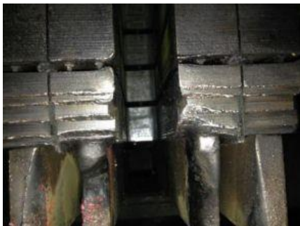
Figura 6 Pacote fundido na ranhura 60 antes do reparo
