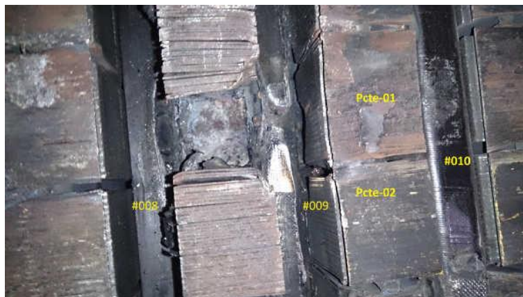
FIGURA 2 – Fusão de material observada na inspeção do estator
