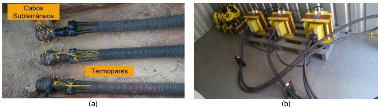
FIGURA 1 – Fotos do arranjo experimental: (a) conexão dos cabos de energização com a linha subterrânea; (b) transformadores de energização dos circuitos.
